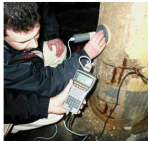
Prueba GalvaPulse en proceso para la actividad de corrosión en una columna altamente corroída.
