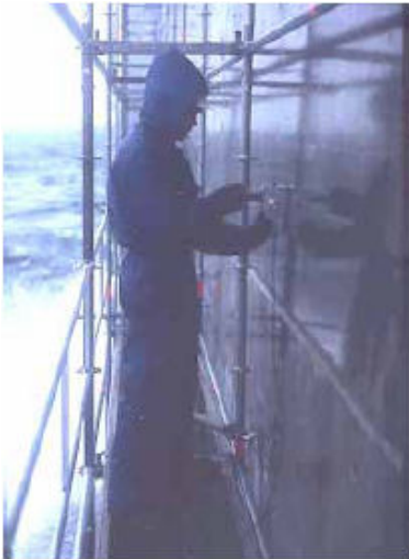
Detección de grietas en bloques de un puente
