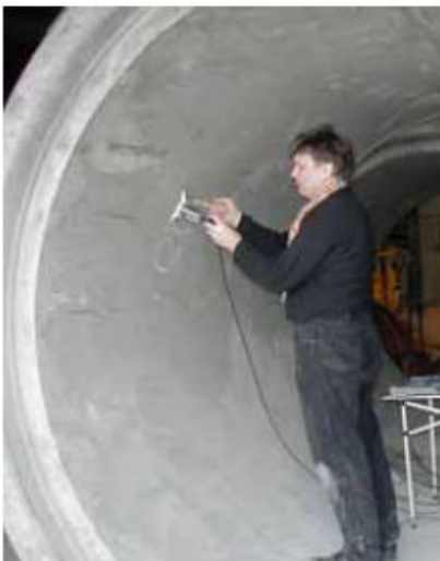
Detección de delaminaciones y segregaciones en tubería de drenaje
